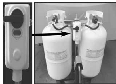
Régulateur de propane automatique à deux étapes retrouvé généralement sur les réservoirs double
