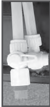
Robinet de purge du réservoir d'eau
